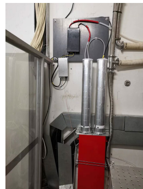
(b) 高压平台打火保护电路实物
